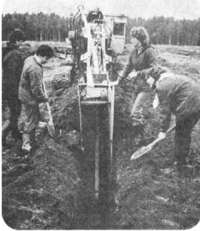
Бойцы отряда «Энтузиаст» Института водного транспорта помогают мелнораторам давать «вторую жизнь» полям совхозов Кингисеппского района. На снимке А. Владимиров вы видите, как одна из бригад отряда готовится к укладке дренажа.
