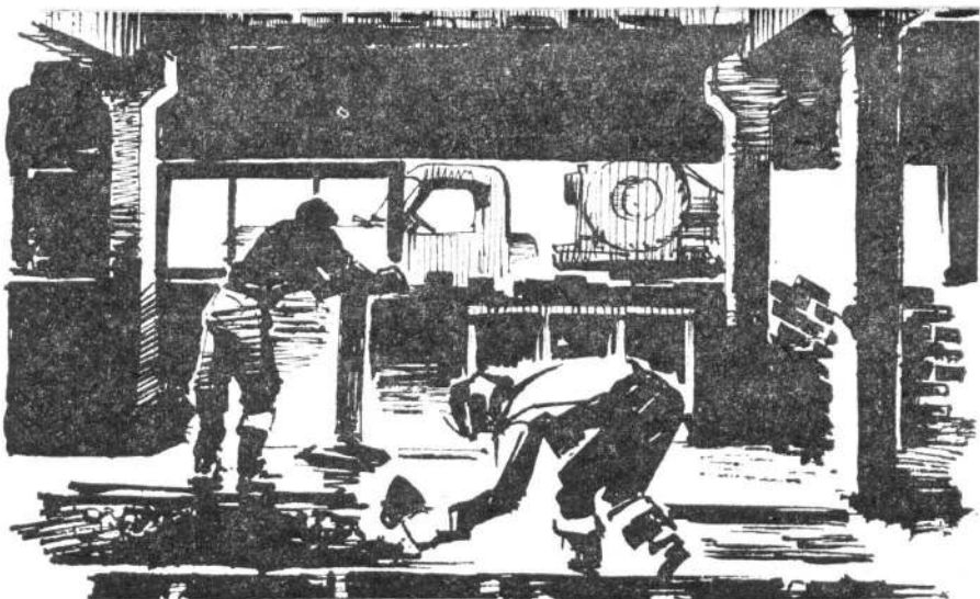
С ЭНТУЗИАЗМОМ, без перекуров работает бригада бетонщиков Саши Зеленого. Объект надо сдать в конце августа. Только бы вовремя подвозили бетон...
