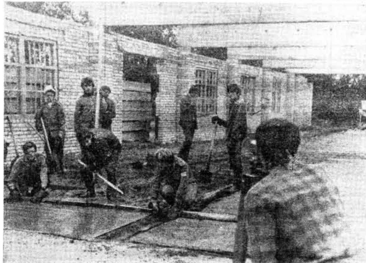
Метр за метром ложится бетон в новом цехе переработки плодов совхоза «Сиробово». Бойцы отряда «Ладога-В» (ЛЭТИ, командир Г. Агранов) торопятся успеть и спрону: скоро домой, а объект сдасточный.
